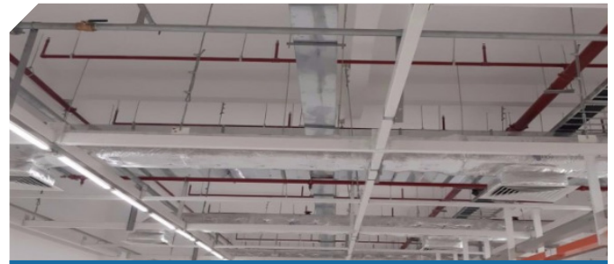
THI CÔNG HỆ THỐNG TỦ ĐIỆN, THANG MĂNG CÁP VÀ CHIẾU SÁNG
